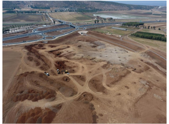
חפירת המאגר ושמירת קרקעות שנחפרו לצורך בניית שיח' למניעת סחף קרקע (באדיבות רשות ניקוז ונחלים ירדן דרומי)
