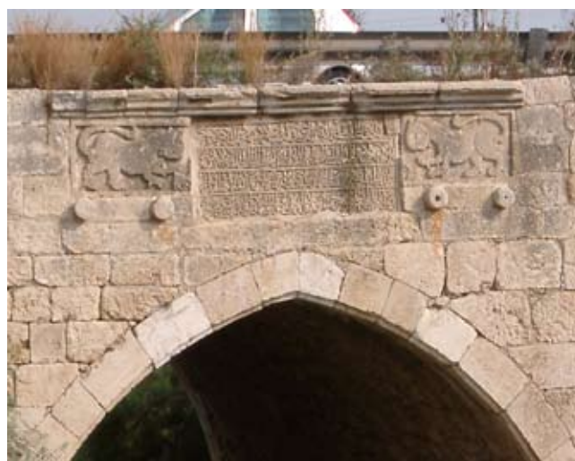
גשר לוד – גשר מהתקופה הממלוכית: על הגשר המעוטר בתבליטי אריות יש כתובת המציינת את שמות הבונים ותפילה לשלום
