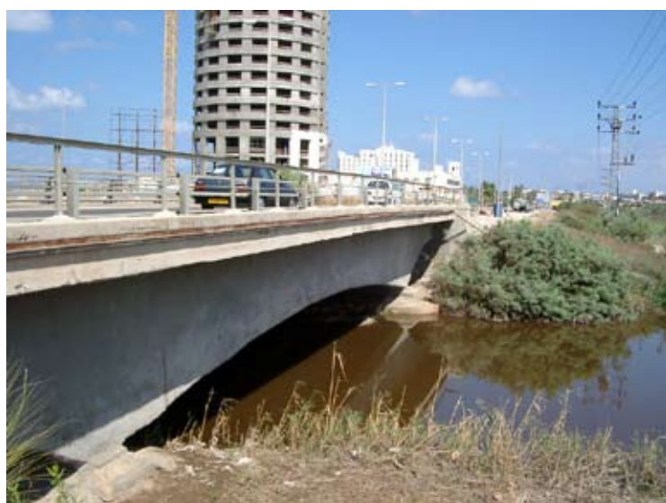
נחל נעמן, דרומית לעכו. יסודות הכביש אינם מותירים כל מעבר מתחתיו, ורציפות התנועה לאורך הנחל נקטעת
