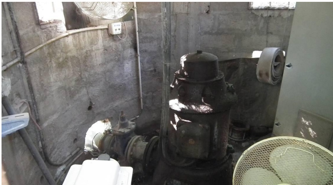
תמונות 80 ו-81: בתמונה עליונה מבט כללי אל מבנה מכון השאיבה בעין סייפן. בתמונה התחתונה מבט אל המשאבה בתוך מכון השאיבה ונקודת היציאה של הצינור.
